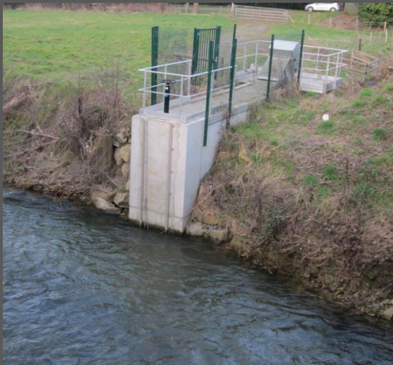
POSTE DE RELEVAGE PAR VIS D'ARCHIMEDE CORBON (14)
