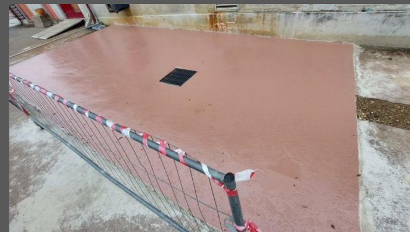
Dalle de dépotage VILLEPREUX (78)
