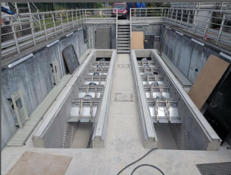
Dessableur MARNE AVAL – NOISY LE GRAND (93)
